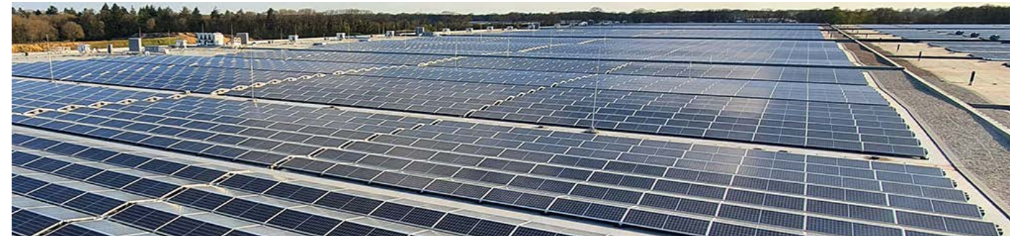
2.34 MWp Art: Hausdach Standort: Niederlande Jahr: 2021 Status: Realisiert
