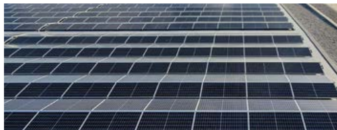
2.50 MWp Art: Hausdach Standort: Deutschland Jahr: 2019 Status: Realisiert
