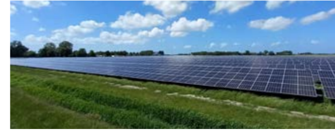
15.00 MWp Art: Freiflächen Anlage Standort: Niederlande Jahr: 2021 Status: Realisiert
