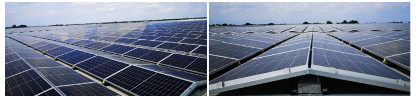
13.00 MWp Art: Hausdach Standort: Niederlande Jahr: 2020 Status: Realisiert
