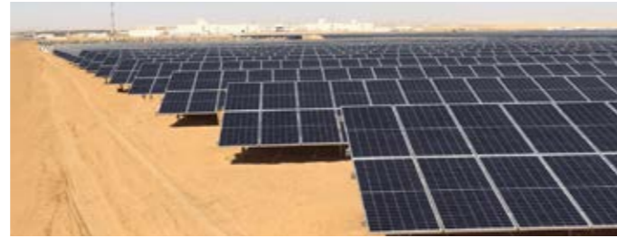
15.00 MWp Tipo: Montato A Terra Anno: 2018 Posizione: Saudi Arabia Stato: Completato
