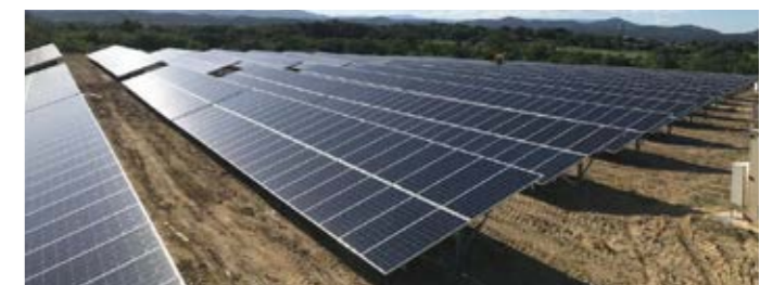
1.32 MWp Tipo: Montato A Terra Anno: 2020 Posizione: Francia Stato: Completato
