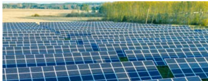
9.40 MWp Tipo: Montato A Terra Anno: 2018 Posizione: Turchia Stato: Completato
