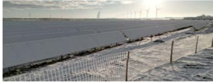
29.00 MWp Tipo: Montato A Terra Anno: 2022 Posizione: Danimarca Stato: In costruzione
