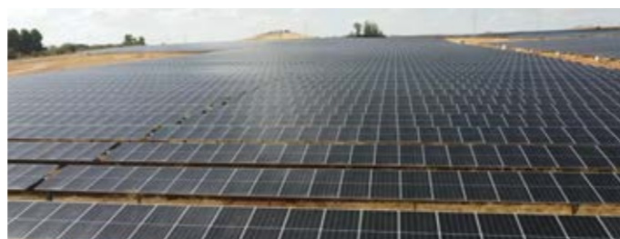
20.00 MWp Tipo: Montato A Terra Anno: 2021 Posizione: Spagna Stato: Completato
