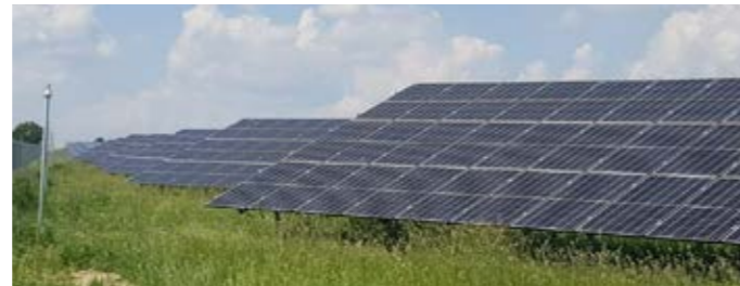
7.00 MWp Tipo: Montato A Terra Anno: 2018 Posizione: Polonia Stato: Completato
