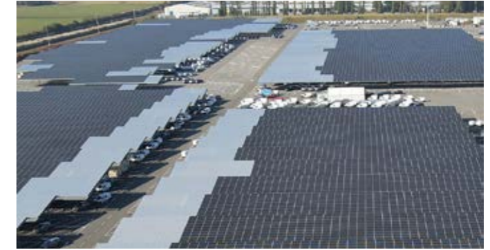
12.00 MWp Tipo: Carport Anno: 2021 Posizione: Francia Stato: Completato
