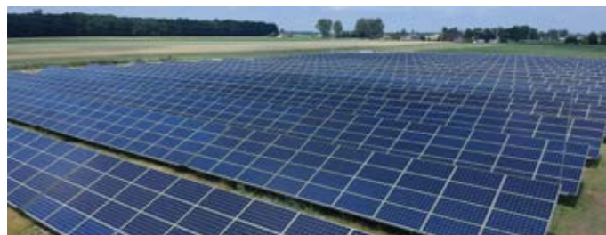
33.00 MWp Tipo: Montato A Terra Anno: 2021 Posizione: Polonia Stato: Completato
